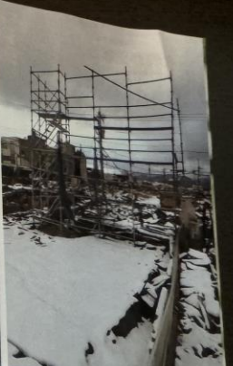
朝市の場で今月末にオープン予定だった完成間近の建設中の新ギャラリーは、足場だけを残して完全に壊れ落ちた。
